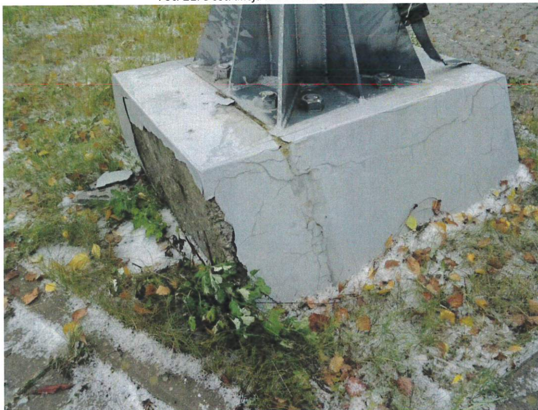
Fot. 22. Destrukcja mrozowa fundamentu
