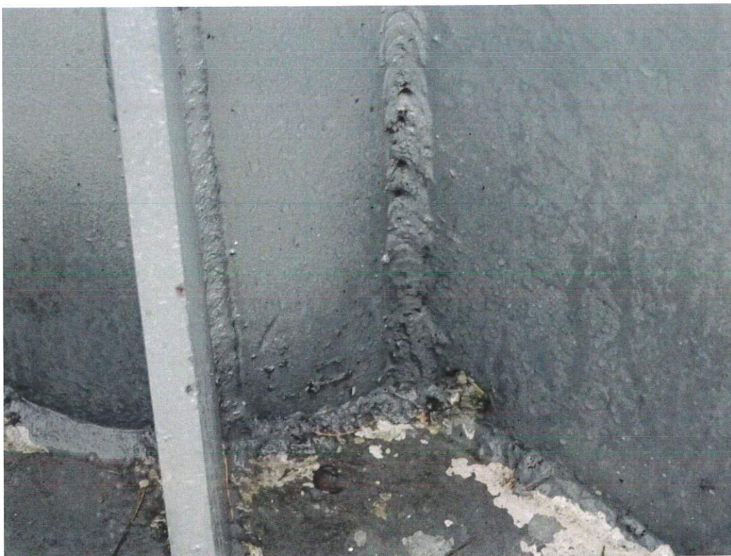
Fot. 17. Wady połączeń spawanych
