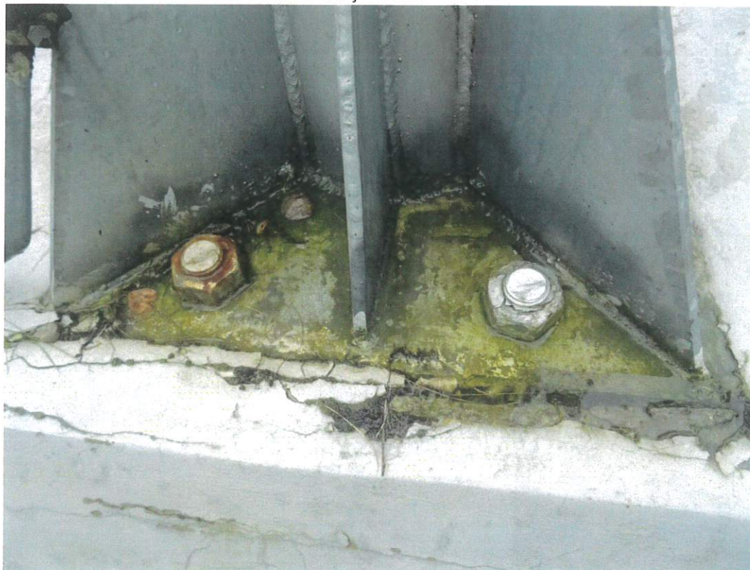
Fot. 24. Destrukcja mrozowa fundamentu
