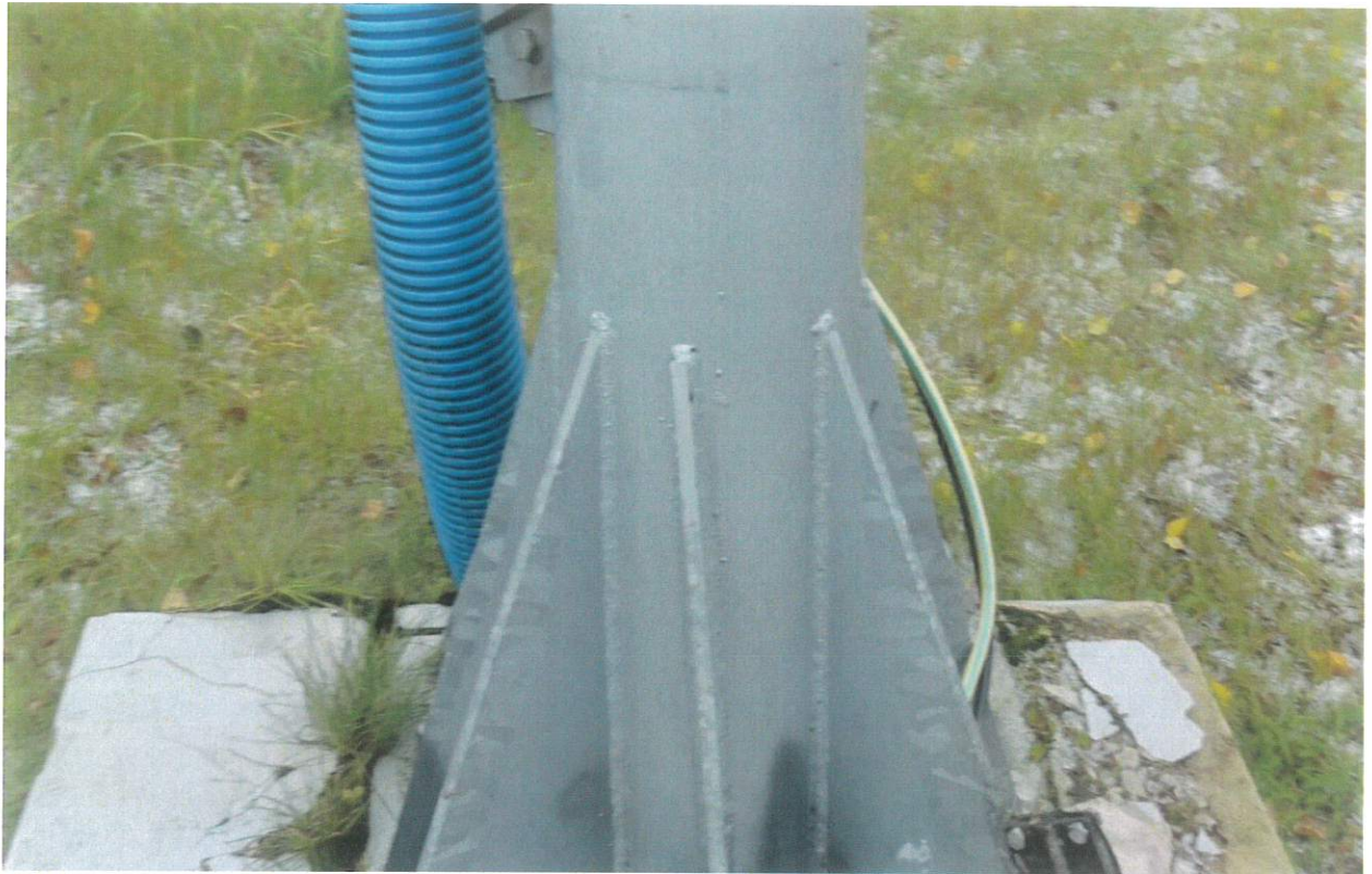
Fot. 19. Krzywo przymocowane blachy wzmacniające węzeł
