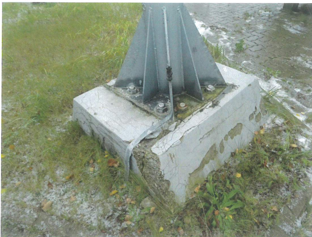
Fot. 23. Destrukcja mrozowa fundamentu
