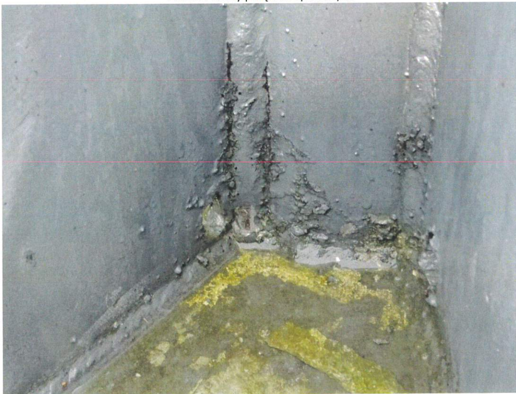
Fot. 18. Wady połączeń spawanych
