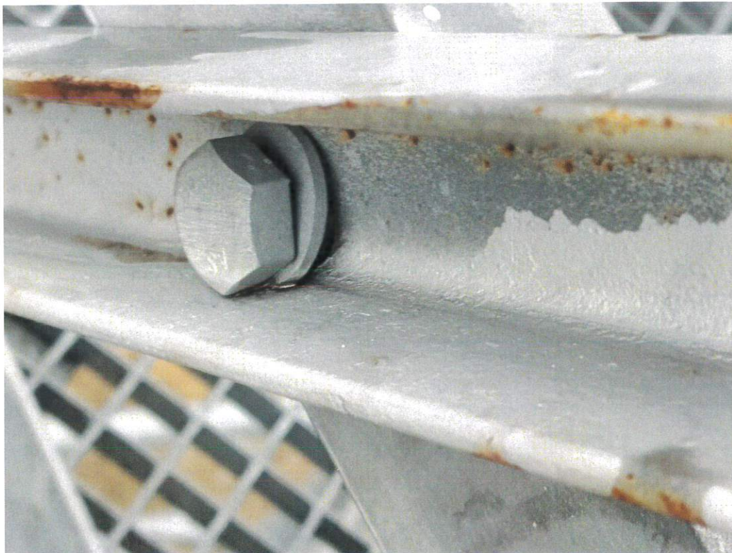
Fot. 7. Nieprawidłowo dobrane złącze śrubowe
