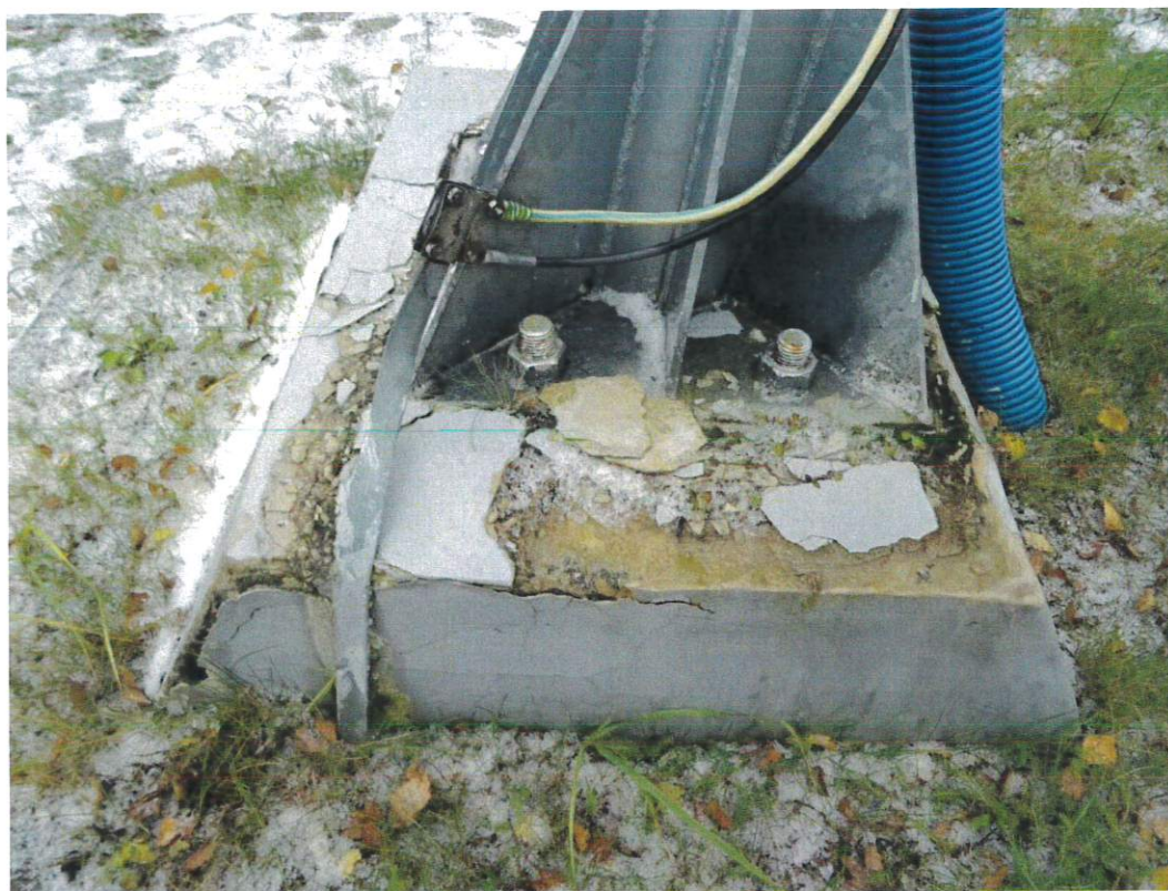
Fot. 21. Destrukcja mrozowa fundamentu
