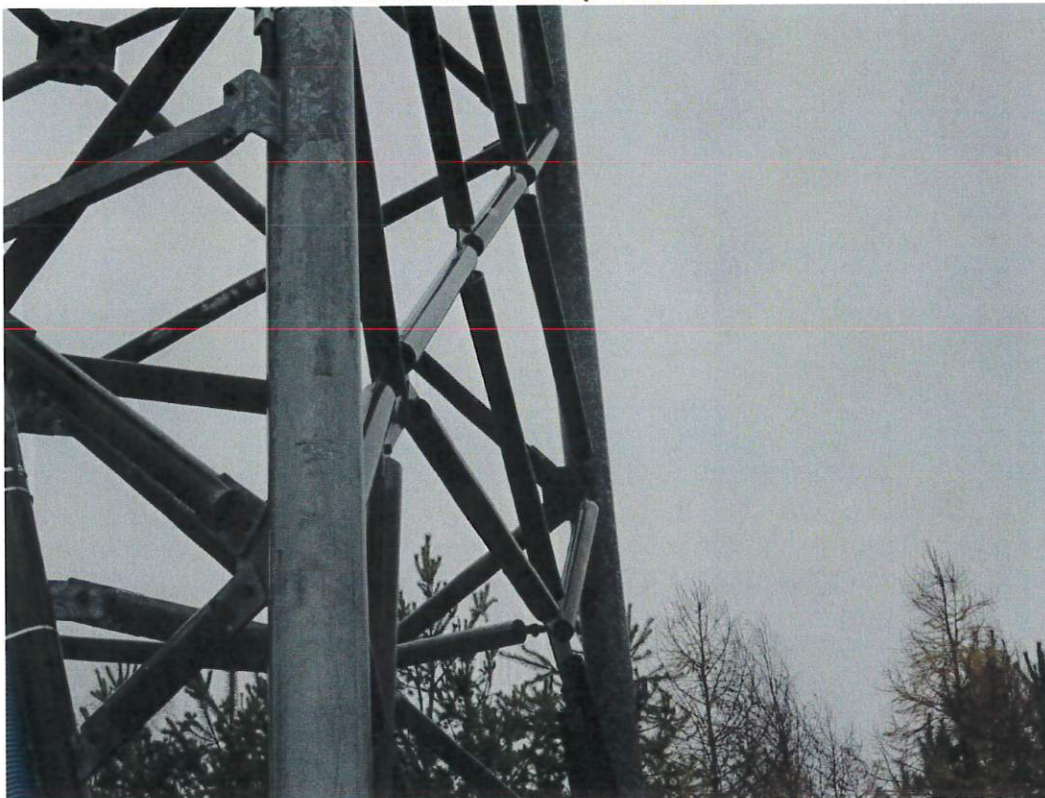
Fot. 13. Skratowanie odkształcone z płaszczyzny
