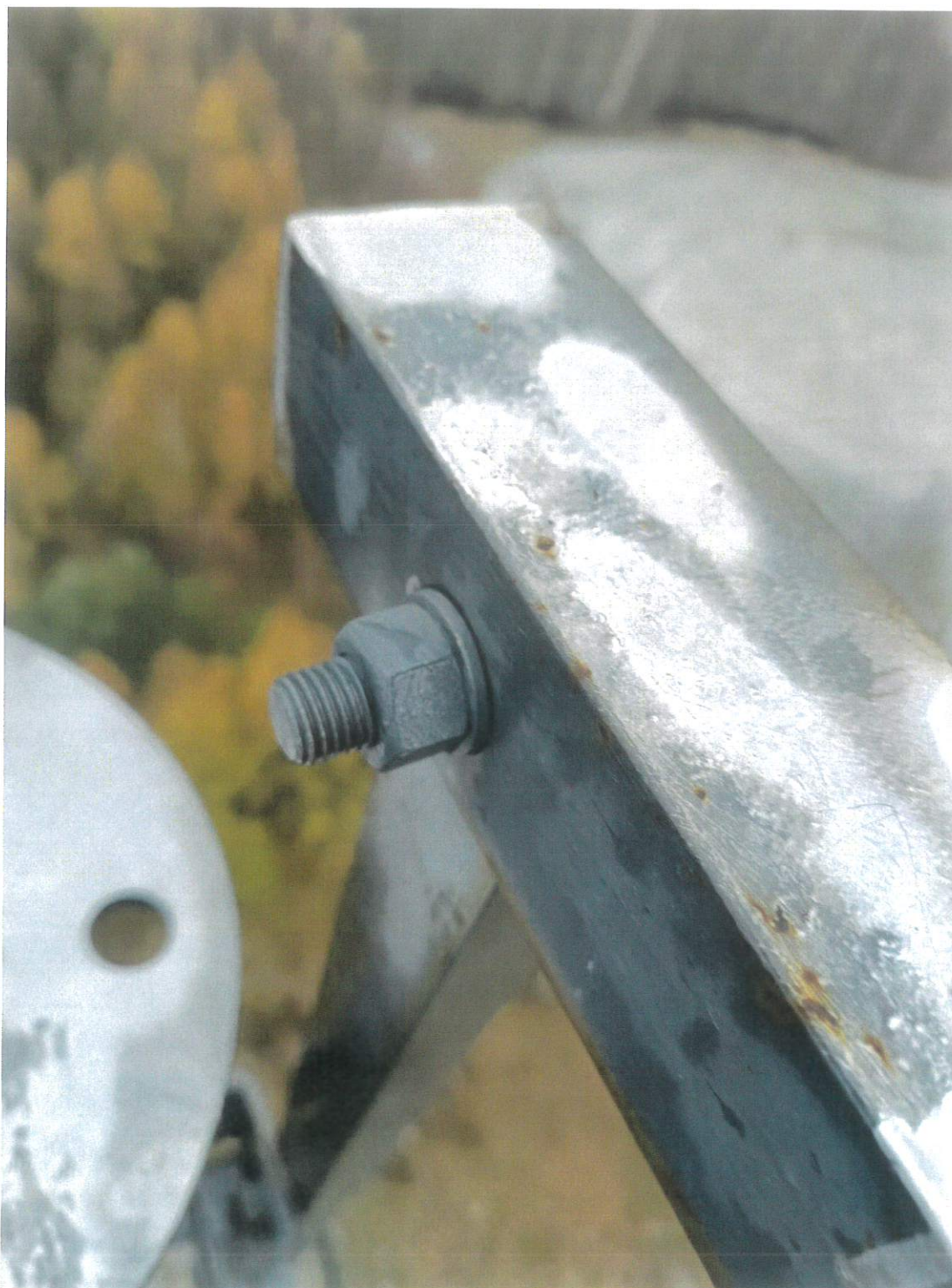
Fot. 6. Korozja, brak podkładek w połączeniu pomocniczym
