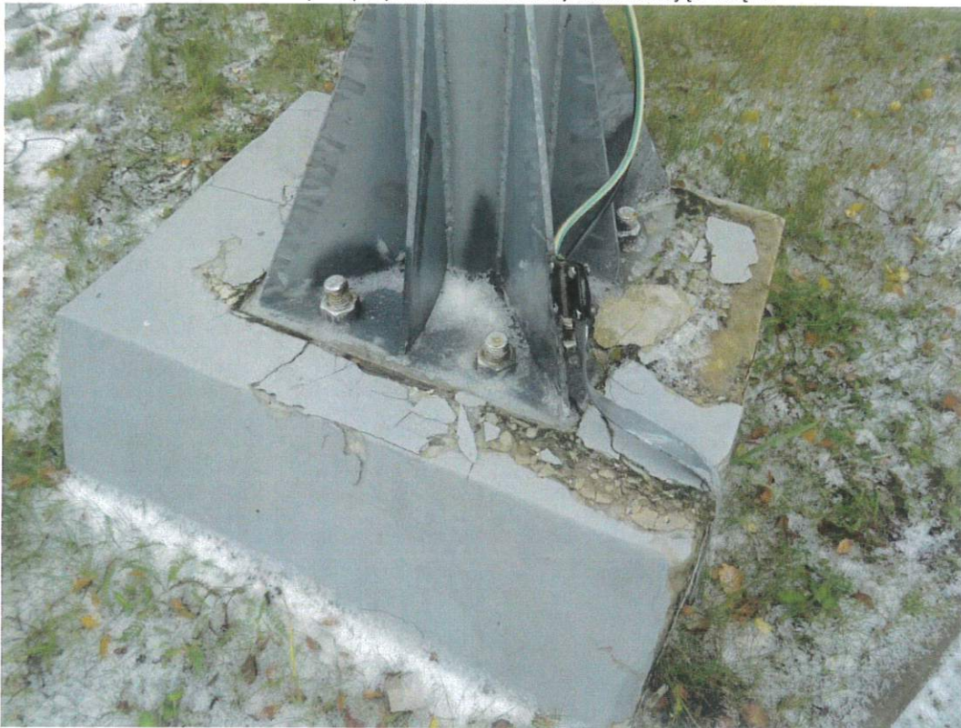
Fot. 20. Destrukcja mrozowa fundamentu
