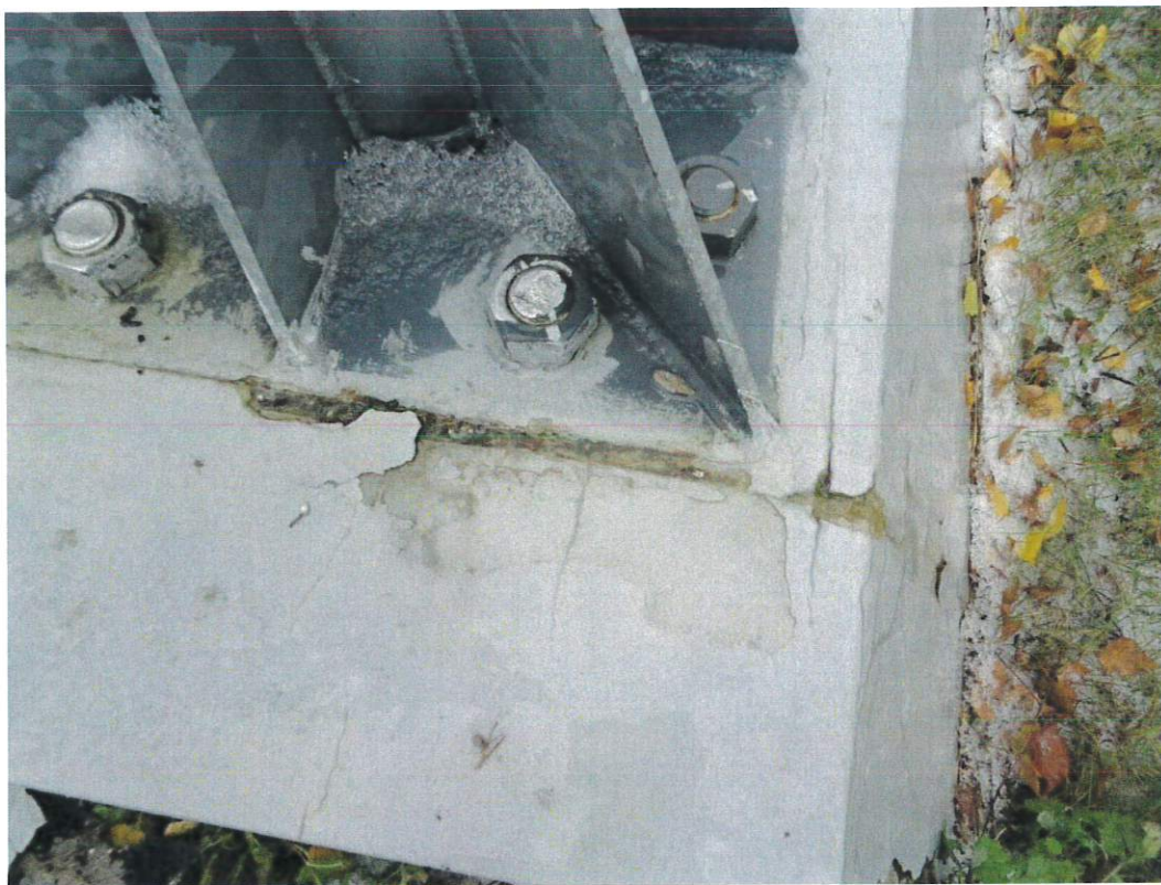
Fot. 25. Destrukcja mrozowa fundamentu
